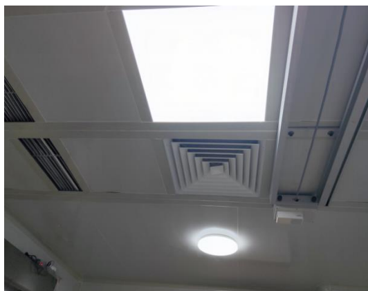
DSA 机房排风
